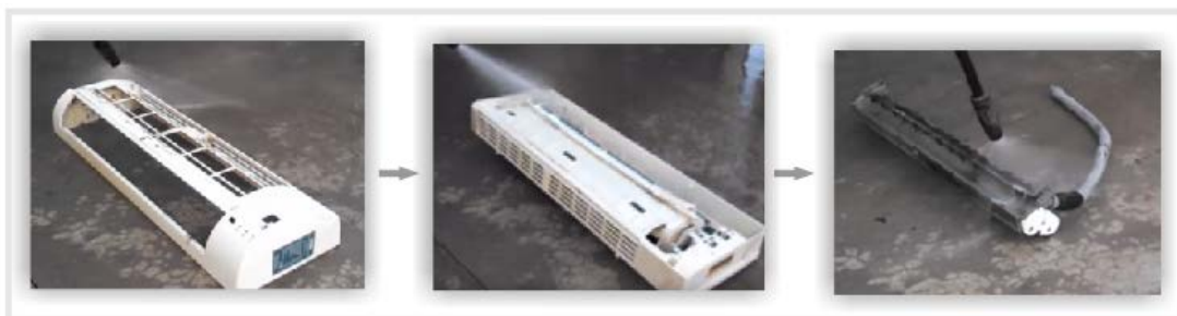
Figura 32. Limpieza de tapas, bandeja y manguera de desagüe.
