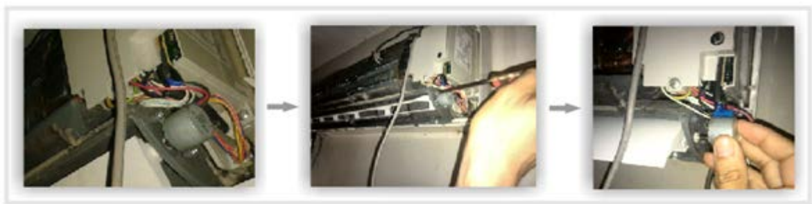
Figura 27. Desconexión del motor que mueve el deflector.
