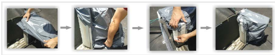
Figura 38. Protección de elementos eléctricos
