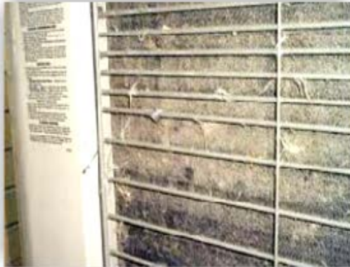
Figura 7. Serpentín de unidad exterior sucio.
