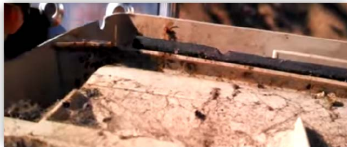
Figura 20. Canal trasera de desagüe sucia.
